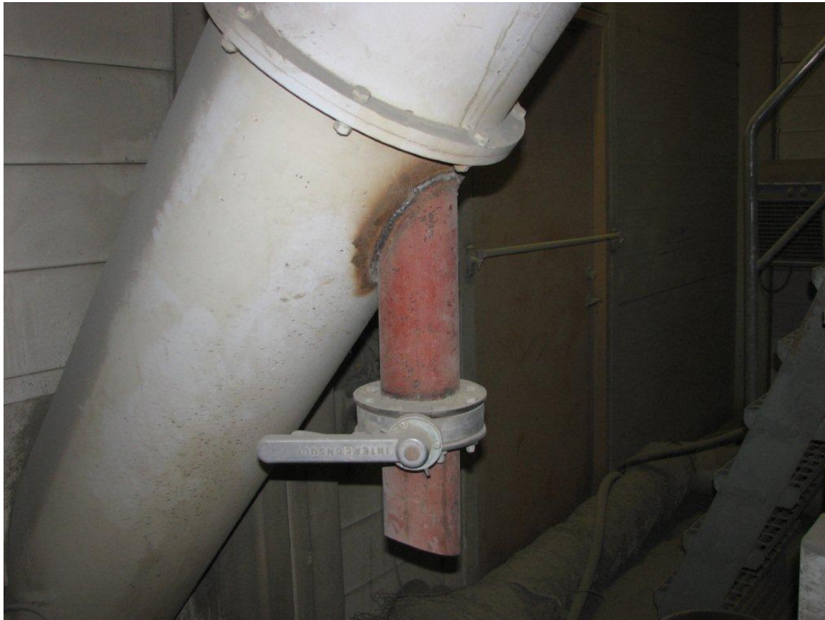
Bild 3: Ventil för uttag av cement från cementskruv
