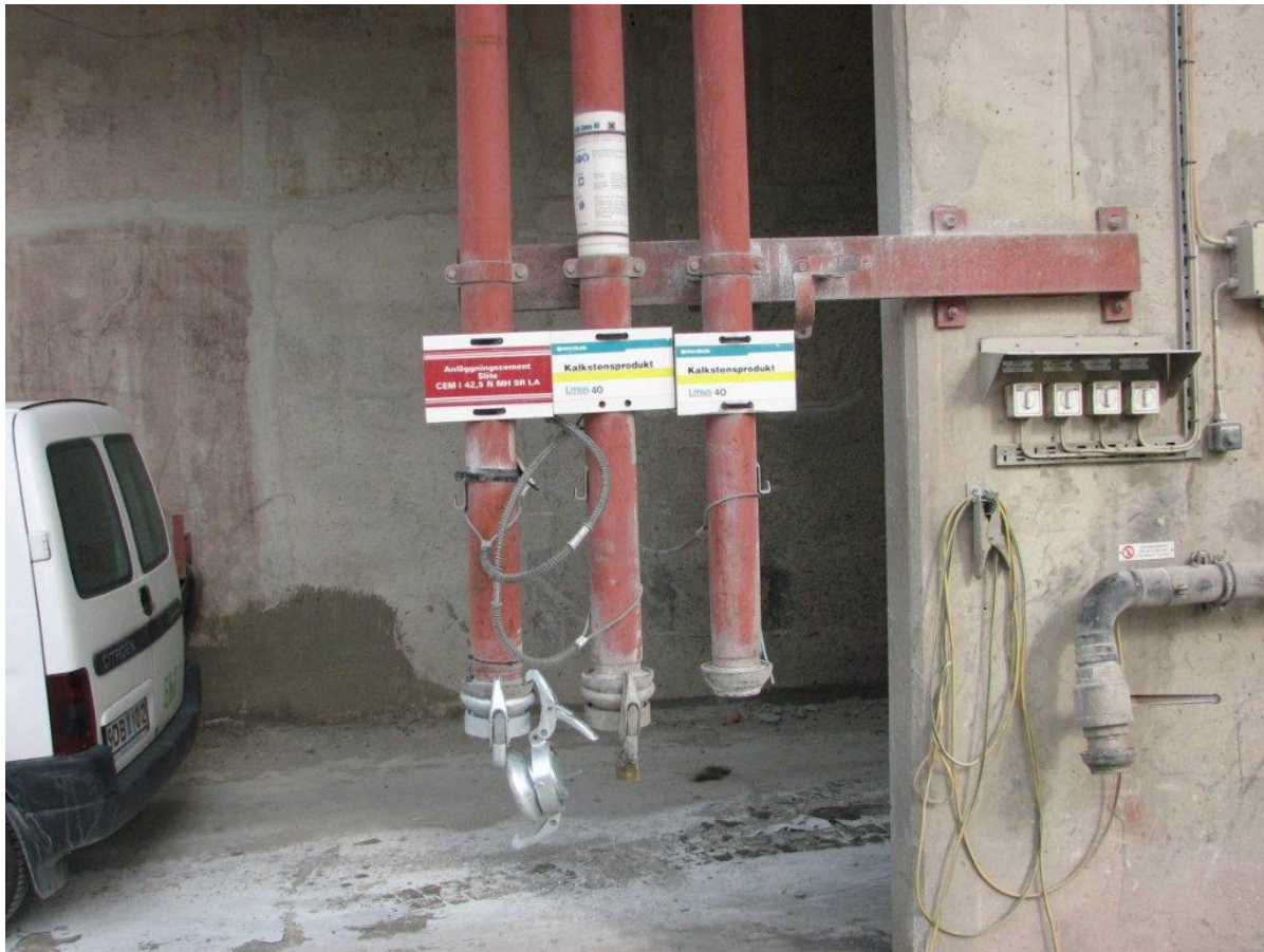
Bild 1: Stålrörsledning som leder upp till cementsilotopp
